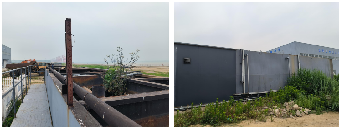
图 5.1-7 施工现场的生活污水处理系统
