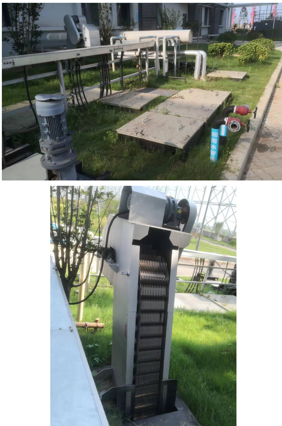
图 5.2-5 洗衣废水预处理设施现场照片
