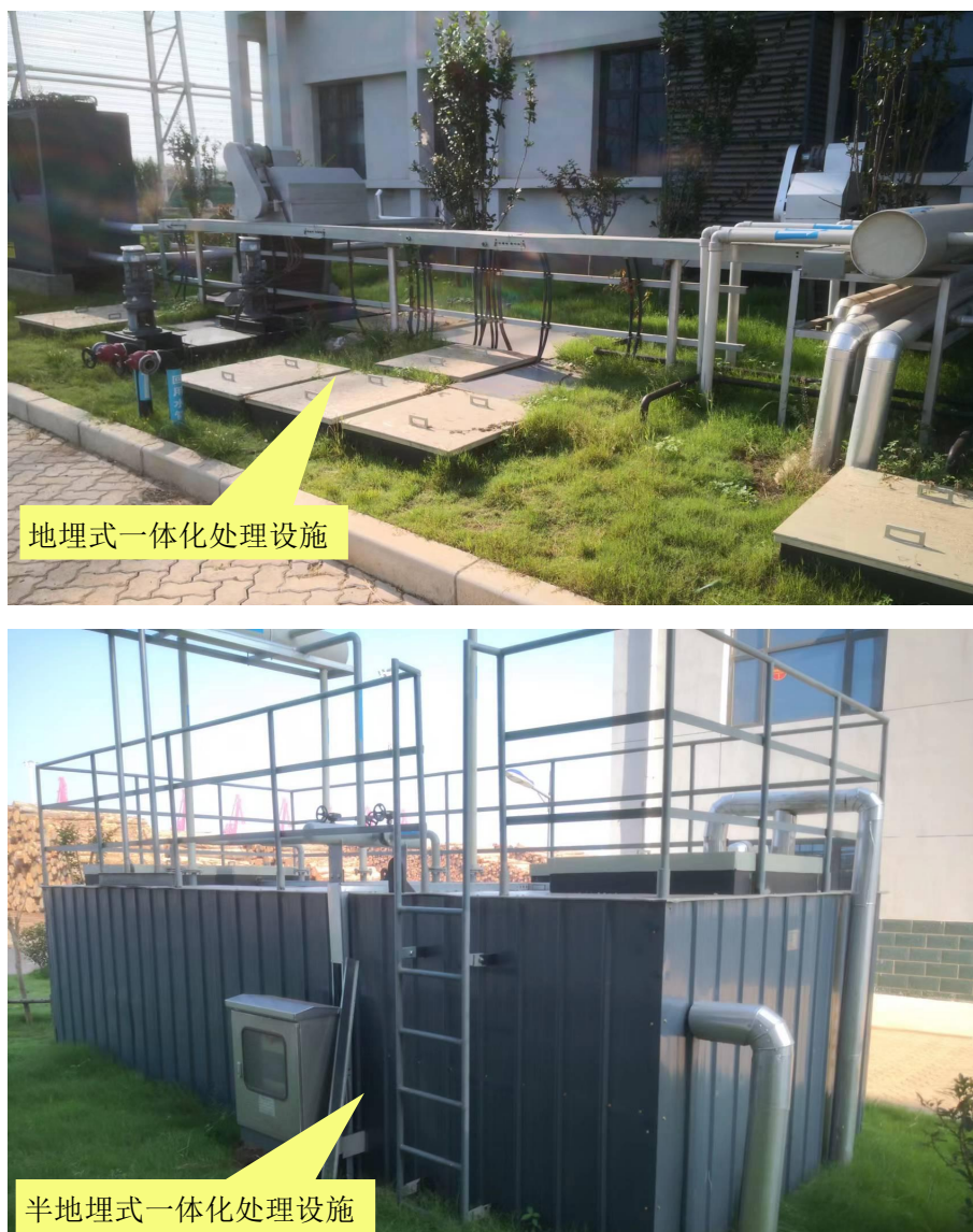
图 5.2-3 生活污水处理设施现场照片
