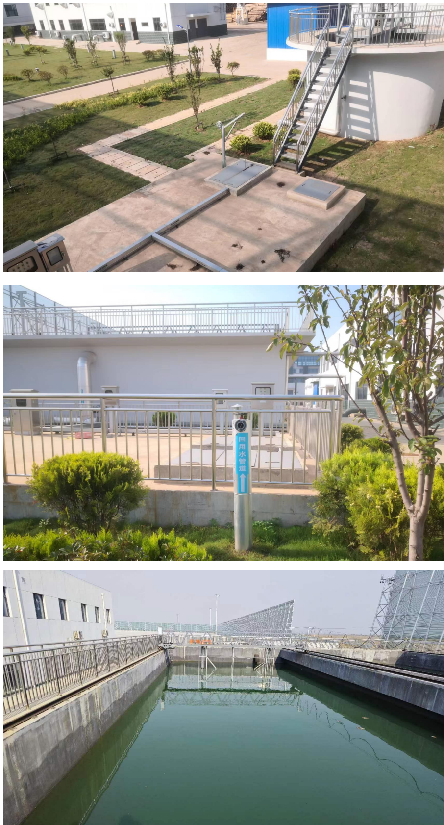
图 5.2-8 含矿废水处理设施现场照片
