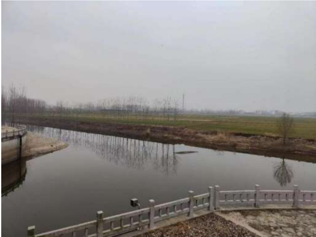
图 3-4 大型泄洪口门对面河坡冲刷、坍塌现状照片
